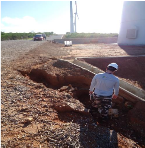
Figura 2 – Processo acelerado de ravinamento decorrente de escoamento laminar, associado a diferença do gradiente topográfico em relação a via de acesso interna da usina eólica.
