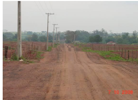
Figura 2. Estrada após a readequação, no ano de 2008. Mesmo local da figura 1. Visão da montante para jusante.
